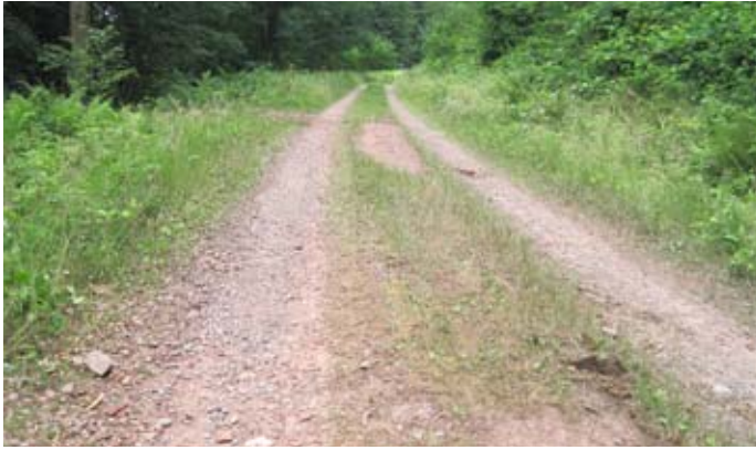
Bild 2: Ein Ausbleiben der regelmäßigen Wegeunterhaltung führt zu zugewachsenen Banketten und deutlicher Gleisbildung.
